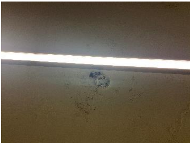
Fotografia 9: Infiltrações e iluminação (3)
