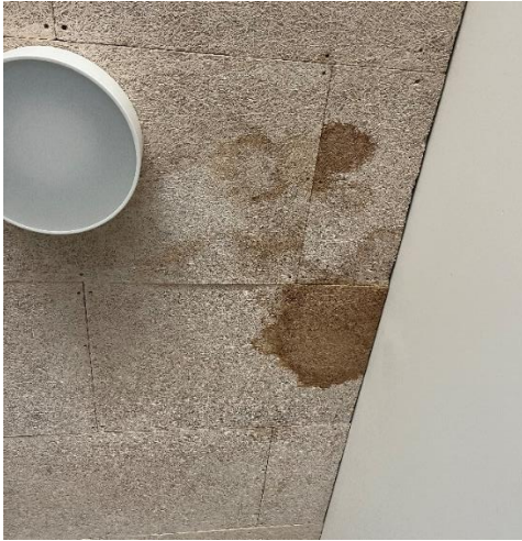
Fotografia 7: Infiltrações e iluminação (1)
