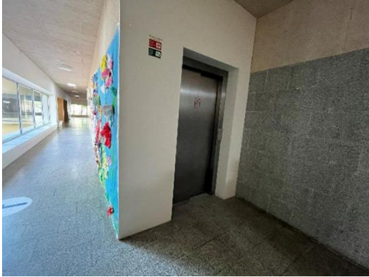
Fotografia 4: Elevador que não funciona
