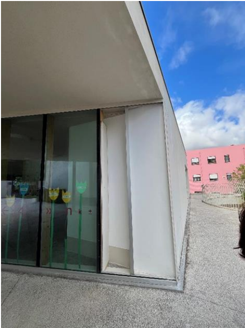
Fotografia 1: Ausência de vidro (que se encontrava partido), ainda não substituído
