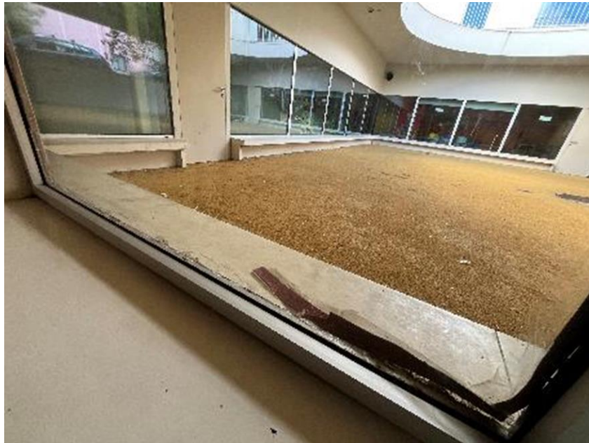
Fotografia 6: Janelas danificadas (vidro duplo partido)
