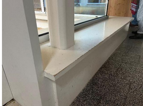
Fotografia 5: Desenho de alguns elementos do edifício desadequado ao uso (bancos com arestas vivas)
