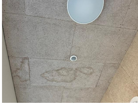
Fotografia 8: Infiltrações e iluminação (2)
