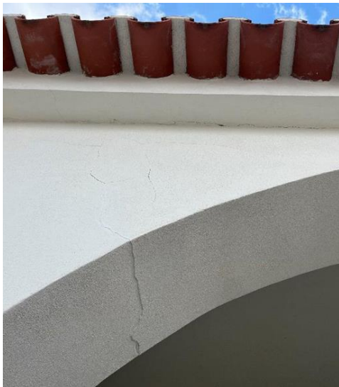
Fotografia 2: Rachas no edifício (1)
