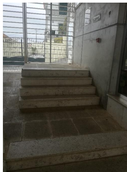
Entrada de acesso ao JI, AAAF e CAF sem corrimão nem proteção
