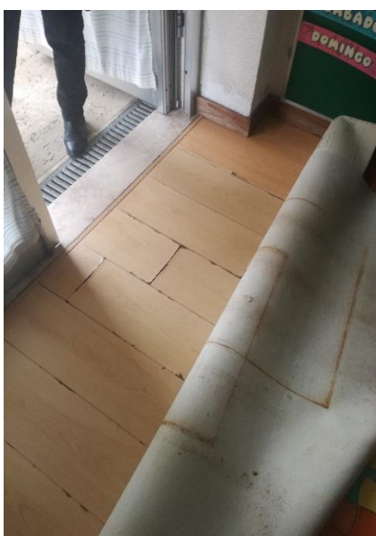
Danos provocados pela entrada e água sala JI
