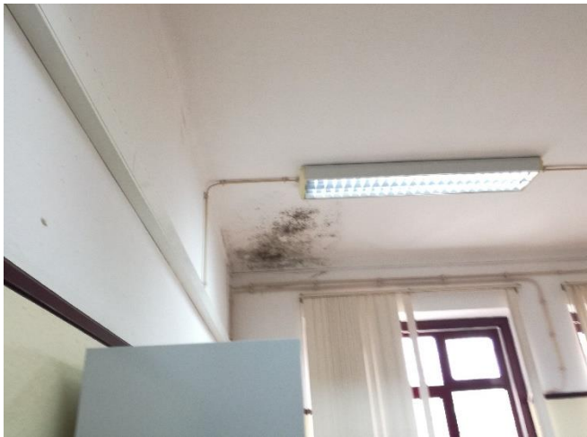
Danos provocados por infiltrações de água
