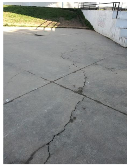
Piso do recreio em mau estado
