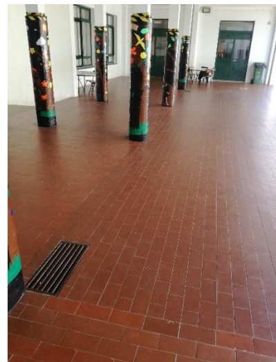
Piso desadequado do espaço de recreio coberto
