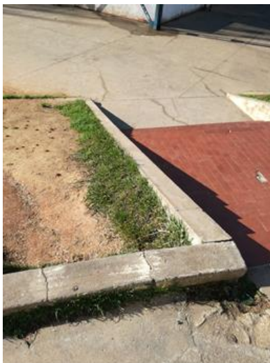
Espaços com desníveis e sem proteção no recreio
