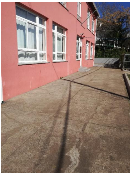
Piso do recreio em mau estado
