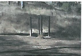
Equip. alguma degradação 1
