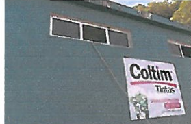
Saída de fio Condutor dos WC
