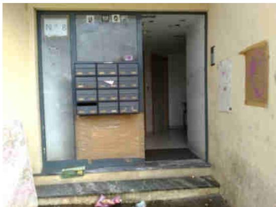
Exemplo evidente de falta de conservação dos prédios na Rua Elísio Moura
