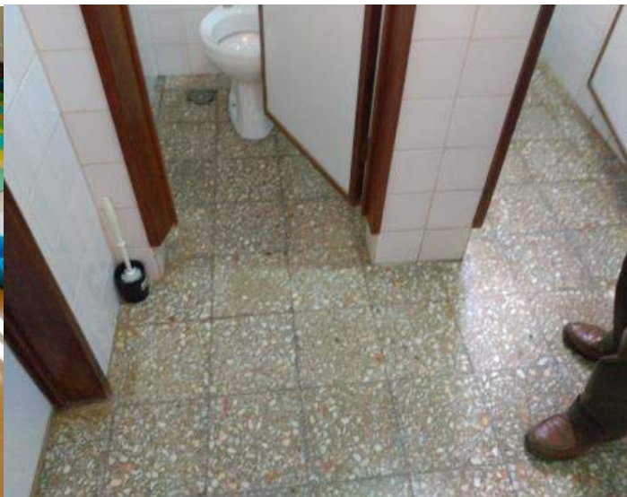
Piso desadequado das casas de banho
