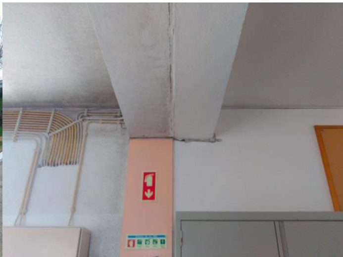
Divisão do interior da escola, entre a parte que foi pintada e reabilitada e a que não foi
