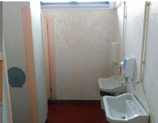
Casas banho a precisar de manutenção
