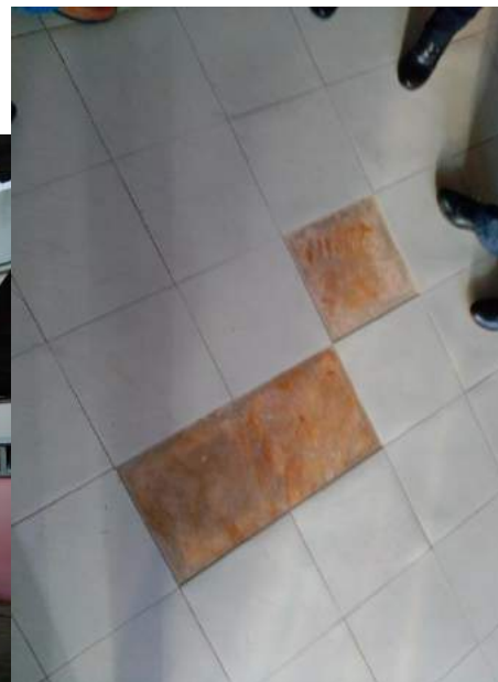
Degradação do piso do refeitório
