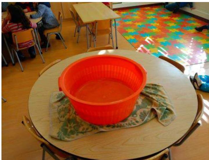
Alguidar que recolhe água da chuva no interior do JI
