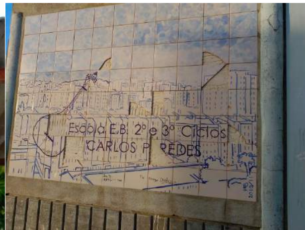
Painel de Azulejo que identifica a escola degradado
