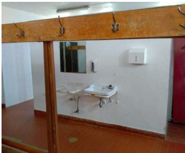
Balneários e respetivos materiais muito degradados
