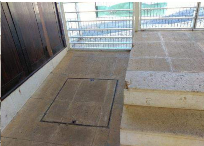
Falta proteção na escada e rampa de acesso,
