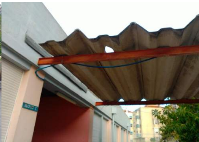
Coberturas de Fibrocimento com buracos e fissuras
