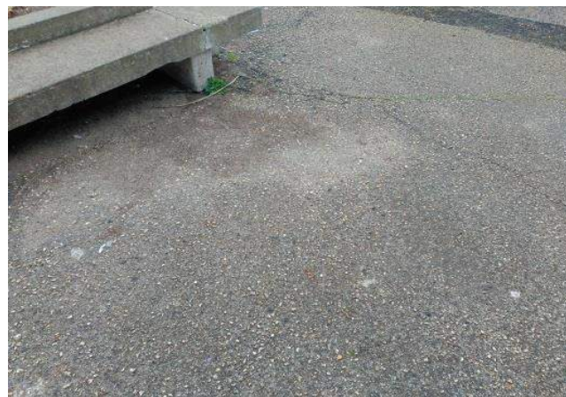
Piso do espaço de recreio em mau estado
