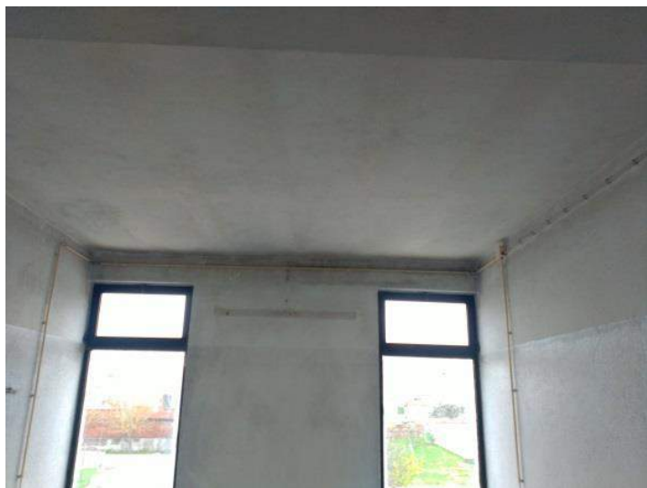
Paredes e tetos cheios de humidade,
