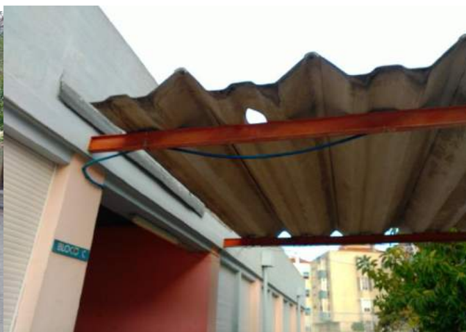
Coberturas de Fibrocimento com buracos e fissuras
