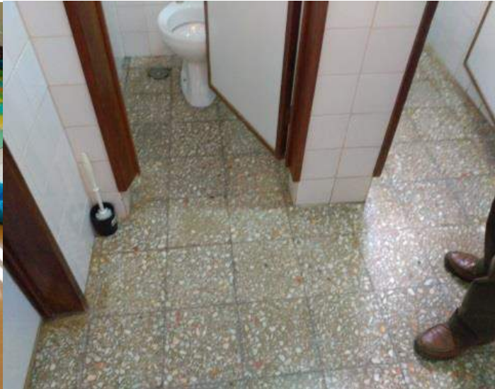
Piso desadequado das casas de banho
