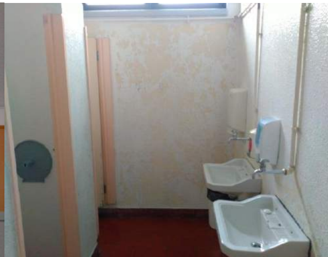
Casas banho a precisar de manutenção
