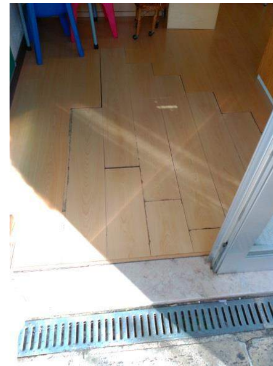
Entrada de sala JI, por onde entra água quando chove
