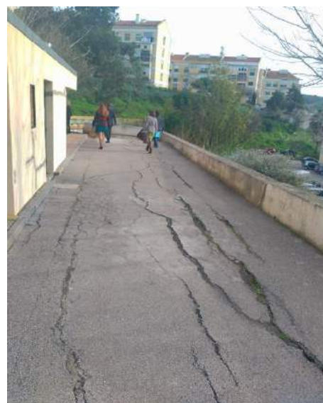
Acesso ao Balneário, onde as fissuras no chão demonstram o risco de aluimento
