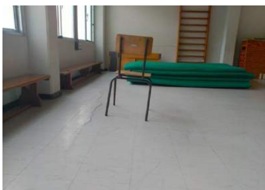
Sala adaptada para Ginásio, onde é visível o desnível provocado pelo aluimento da estrutura
