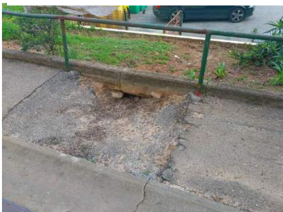
Buraco deixado após intervenção realizada pela Câmara Municipal
