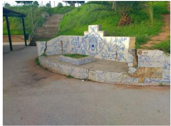
Logradouro que demonstra a falta de sustentação e o perigo de aluimento de terras
