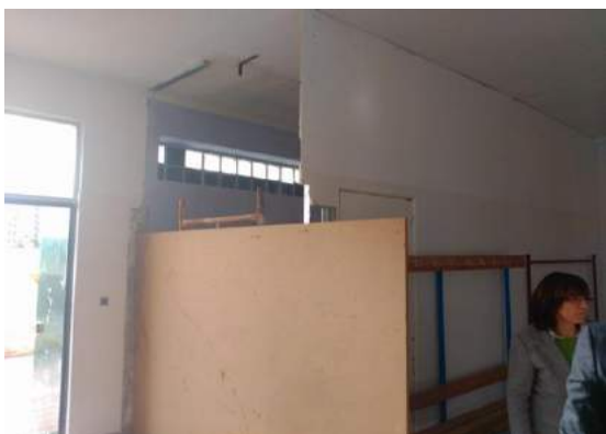
Balneários, onde a parede da Arrecadação teve de ser removida pelo risco de ruir na totalidade
