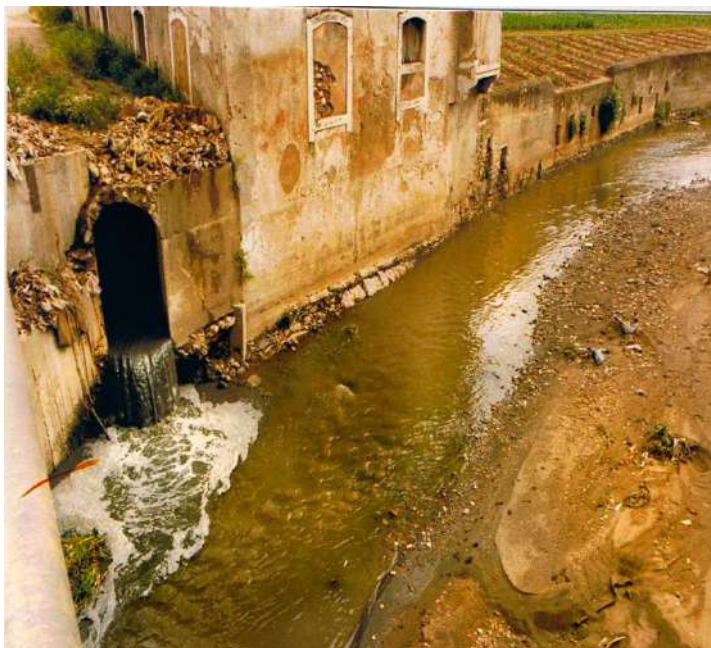
Esgoto para a Ribeira de Odivelas. Foto cedida por Eduardo Batista
