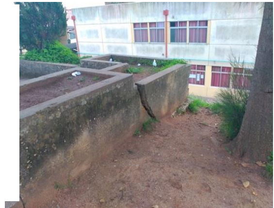
Logradouro que demonstra a falta de sustentação e o perigo de aluimento de terras
