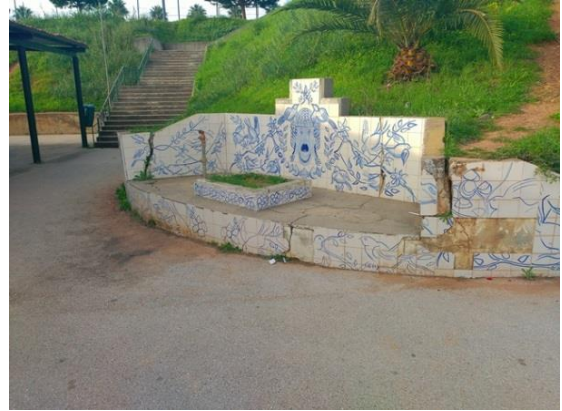
Logradouro que demonstra a falta de sustentação e o perigo de aluimento de terras
