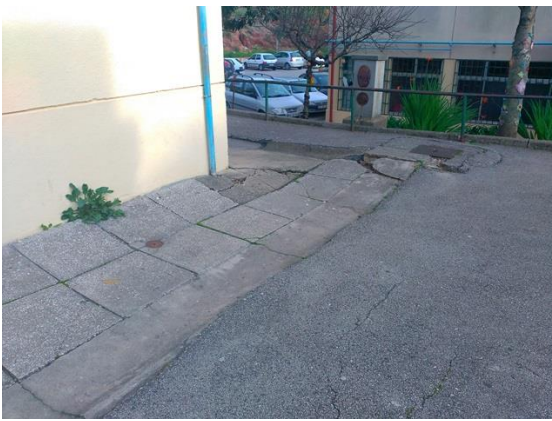
Desnívelamento do Piso que coloca em risco a segurança dos alunos
