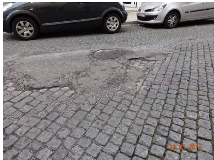
Tampas de saneamento desniveladas Rua Mestre António Martins 22/03/2014
