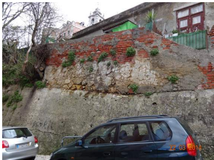
Casa e muro em ruínas Rua Marques da Silva – 2 A 22/03/2014
